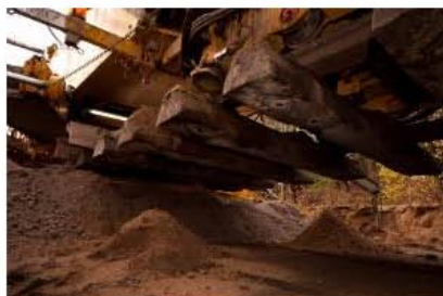
Wie schwerelos: Das Gleisrost schwebt in der Luft, während die Maschine den Unterbau (ein Mineral- und Sandgemisch) ins Gleisbett einbringt © Stadt Buchholz
