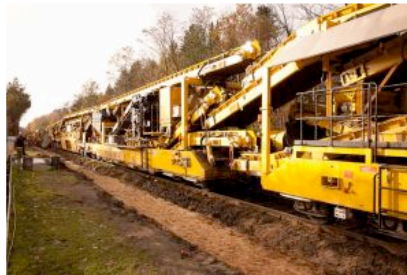
Die weltweit größte Gleisbaumaschine arbeitet zurzeit auf der Heidebahn in Holm-Seppensen © Stadt Buchholz
