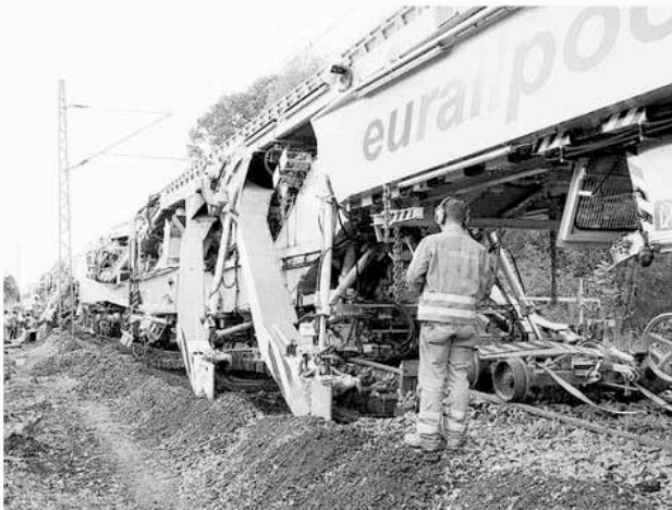
"PM 1000-URM" heißt das 270 Meter lange Ungetüm, das mit mehreren hintereinander arbeitenden Kettenlaufwerken den alten Schotter abträgt und dahinter gleich Sand als neue Untergrundschiicht ausbringt. Foto berger
